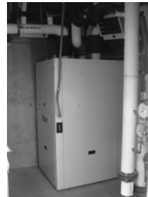
35 Ton Heat Pump
